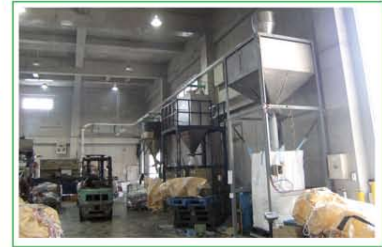
(有)エコテック 四国工場 (プラスチック再生加工)
